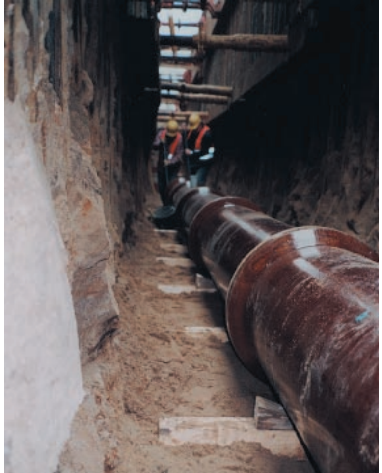
Um ein seitliches Verschieben zu vermeiden, wurden die Rohre beidseitig mit auf Kanthölzern angenagelten Holzkeilen fixiert.
