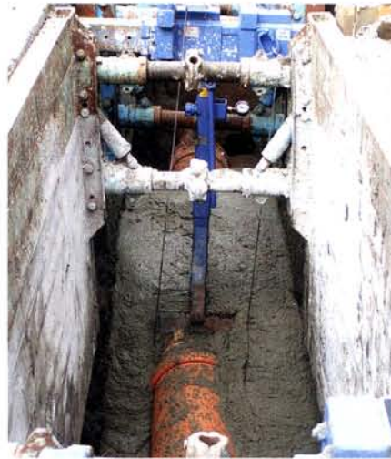
Der Einsatz von Rohrverlegehilfen dient zur Lage-sicherung und der Messung des Auftriebes. Foto: LOGIC
