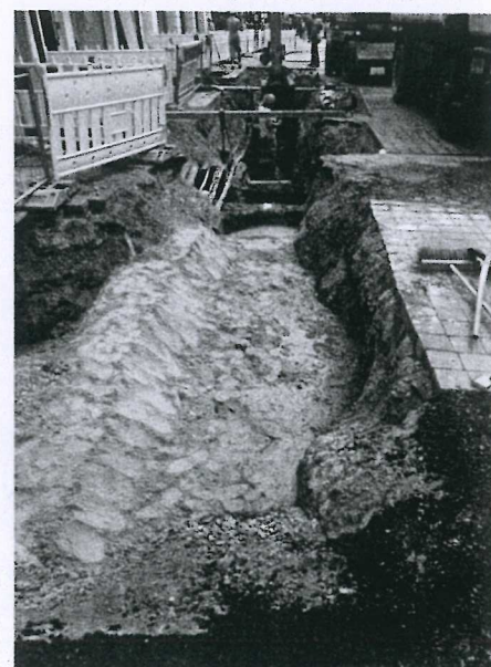
Abb. 8: Ca. 4 Std. nach dem Einbringen des Flüssigbodens, ca. 10 cm unterhalb des Rohrpaketes, konnte bereits das Sandbett eingebaut werden
