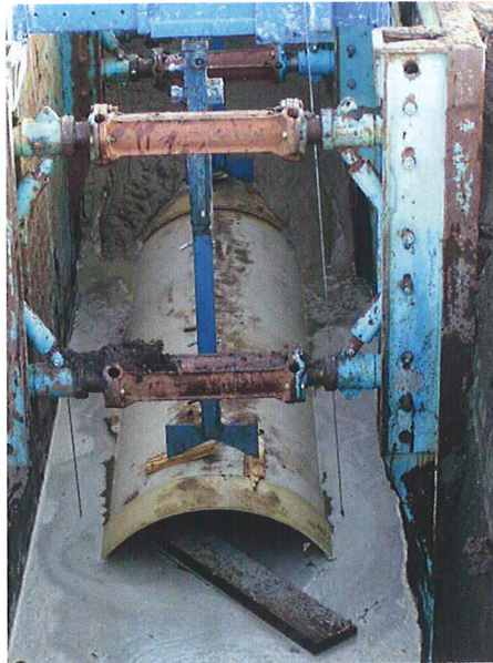
Abwassersammler in Lübeck: Das Flüssigbodenverfahren macht es möglich, ohne aufwändige Verbaulösung im Grundwasser zu arbeiten. Das senkt die Arbeitszeit und vor allem die Kosten.
