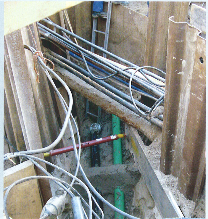
Dort, wo vorhandene Versorgungsleitungen die ordnungsgemäße Verdichtung des Rohrgrabens erschwerten, kam Flüssigboden zum Einsatz. Zu sehen sind die neu verlegten und mit Haltebänken gegen Auftrieb gesicherten Hausanschlussleitungen.
