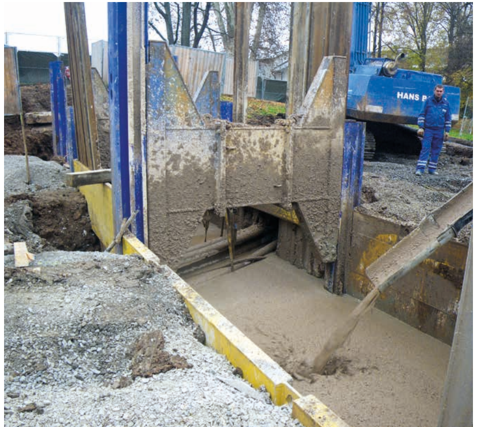
Einbau Flüssigboden in Rohrgraben für DN 2200 im Schlossgarten Stuttgart. | Fotos: Vogel Ingenieure
